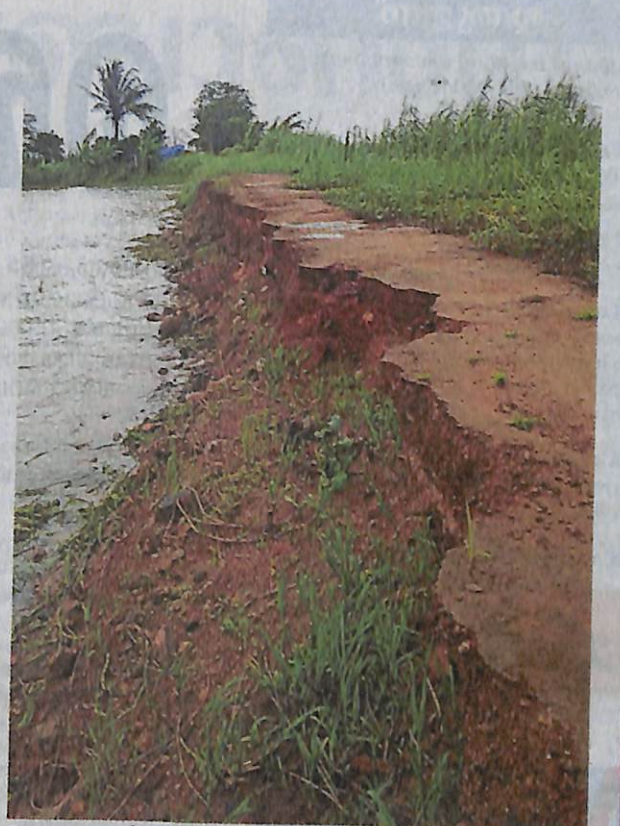
വെള്ളം കുത്തിയൊഴുകി വെങ്കിടങ്ങൾ കിഴക്കെ കരിമ്പാടം കോൾപടവിൽ ബണ്ട് തകർന്ന നിലയിൽ.
