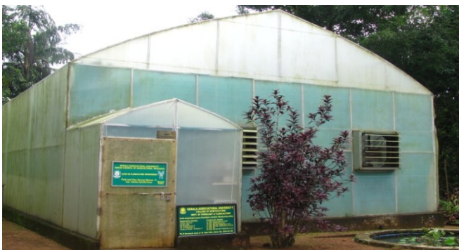
Fan and pad system (S 3 )
